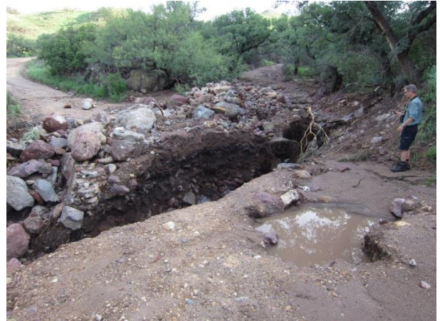
California Gulch, Bortspolad väg!!
